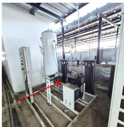
Fotografía n.º 3 Motor ubicado en azotea con emisión de ruido anormal
