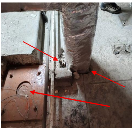
Fotografía n.º 7 Perforaciones realizadas en los pisos del Cuarto de máquinas
