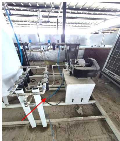
Fotografía n.º 4 Manguera desconectada a uno de sus extremos
